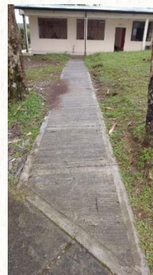
Figura 51. Andén acceso a salas de sistemas
